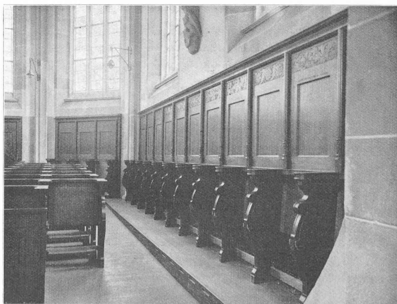
Fig. 5. — Chauffage électrique, système à banquettes, de l'église de Meilen.
