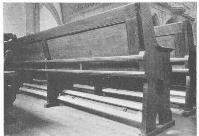
Fig. 3. — Banquettes de chauffage électrique du temple de St-Martin, à Vevey.
