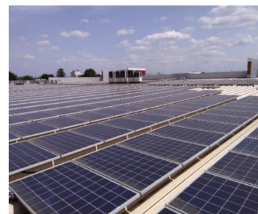
太陽光パネル
