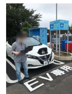
顧客向け EVパワーステーション
